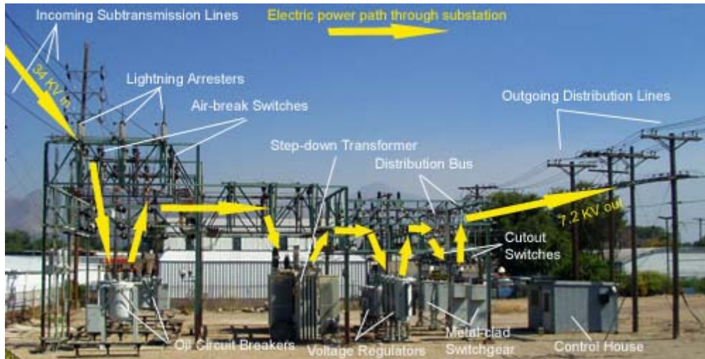
Hình : Trạm biến áp
